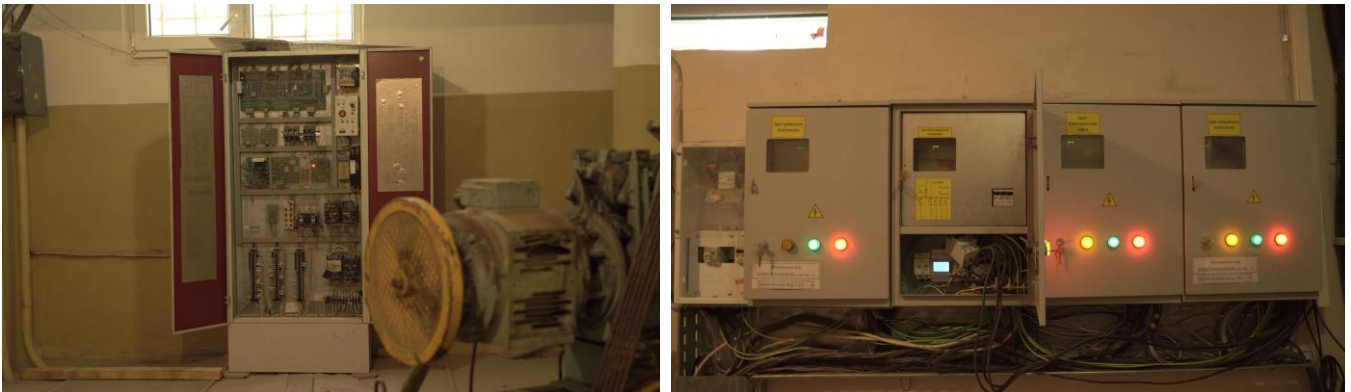
Рисунок – Специфічне обладнання системи ліфта у багатквартирному будинку
